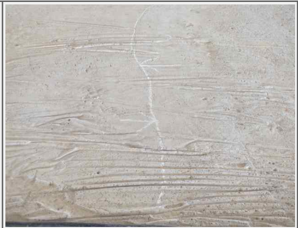
내 용 반정교(영천) P1 코핑부 균열 (cw=0.2mm)
