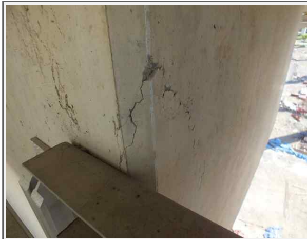
내 용 반정교(상주) P6 코핑부 콘크리트 파손
