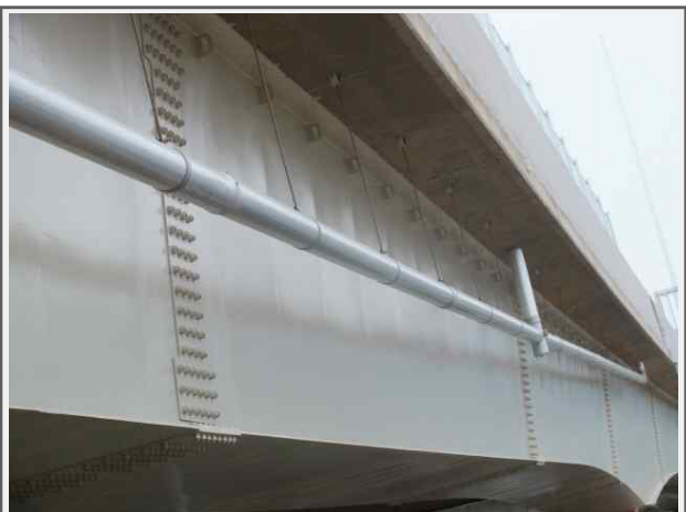
내 용 반정교(영천) 배수관
