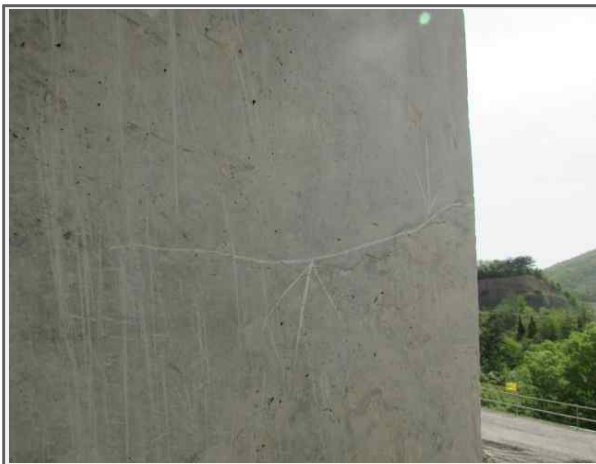
내 용 상주 A1 흥벽 균열 (cw=0.3mm)
