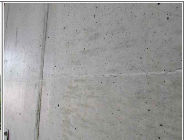
내 용 영천 A1 균열 (cw=0.2mm)
