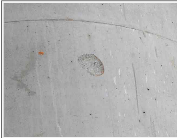
내 용 반정교(상주) P2 기둥 콘크리트 파손
