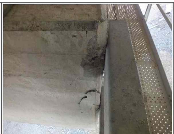
내 용 반정교(영천) P1 코핑부 콘크리트 파손
