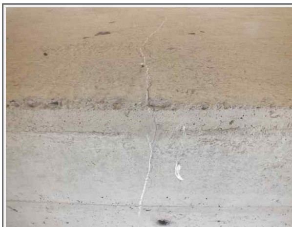
내 용 반정교(영천) P3 코핑부 균열 (cw=0.3mm)
